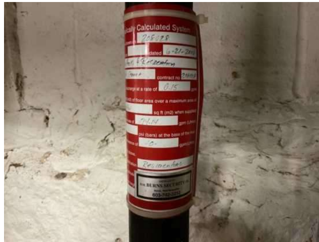
16 - FIRE SUPPRESSION RISER
